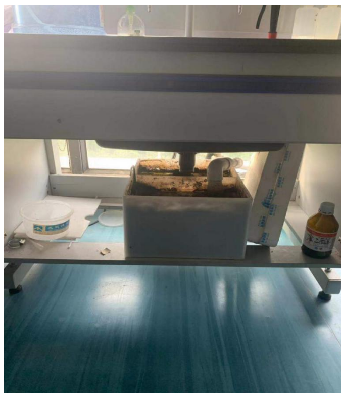
图 4.1-3 酸碱废水中和池（无机前处理室）
