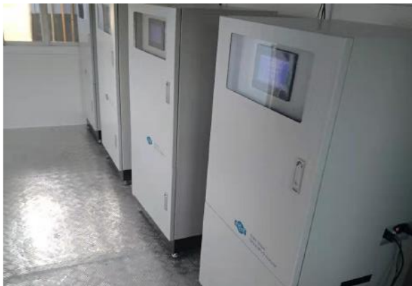
图 4.6-2 污水在线监测系统
