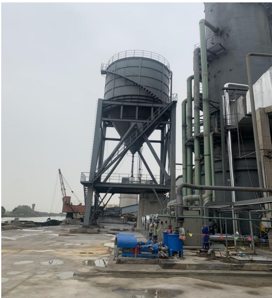
图4.1-1 石灰仓及脱硫塔
