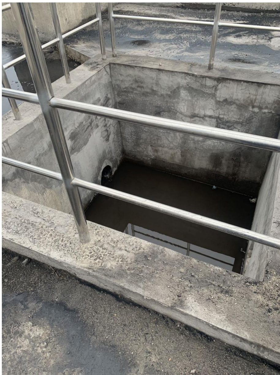
图3.9-1 初期雨水沉淀池
