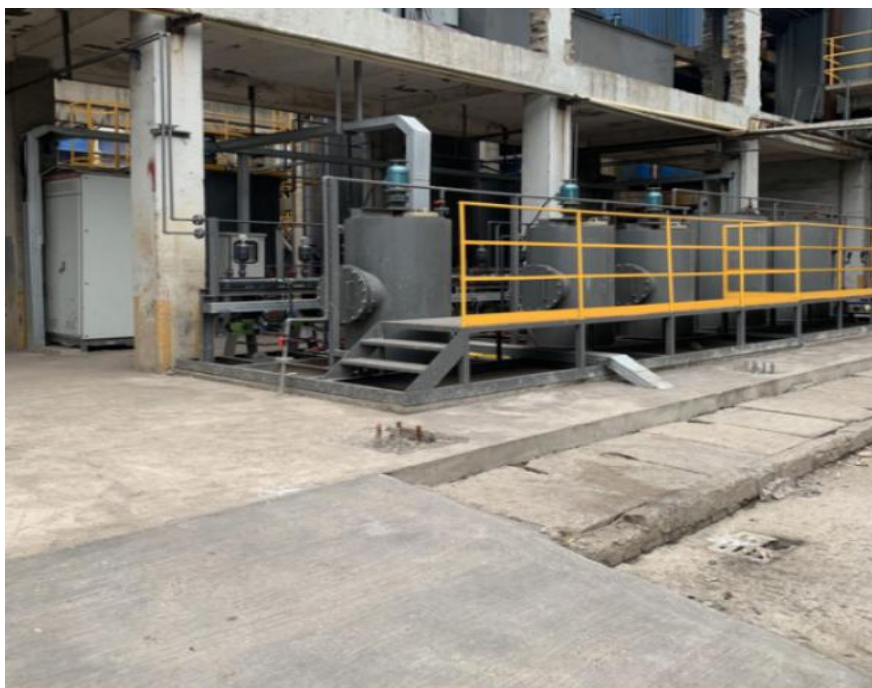
图4.1-9 脱硫废水处理站
