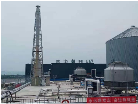
污水处理系统-生化组合池
