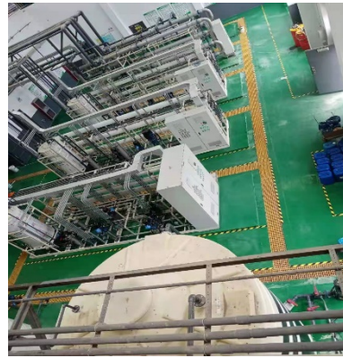
污水处理系统-污水处理车间
