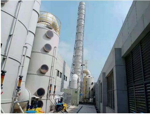
垃圾处理车间废气治理措施 1
