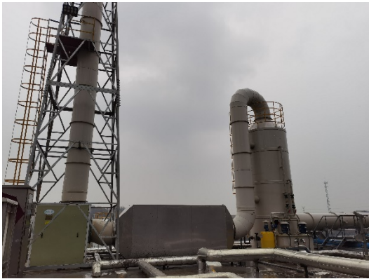
厌氧发酵废气治理措施
