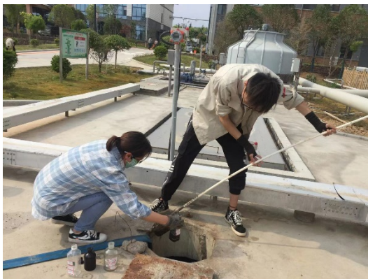
污水进口检测
