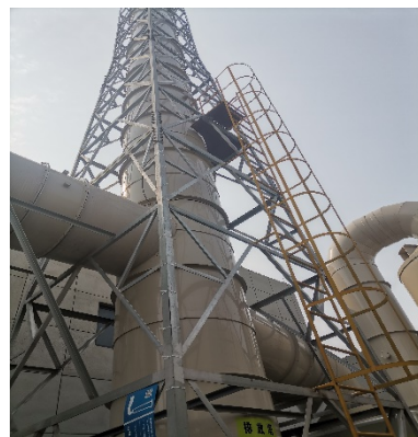
处理车间排气筒出口检测
