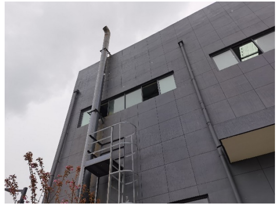
沼气发电排气筒出口
