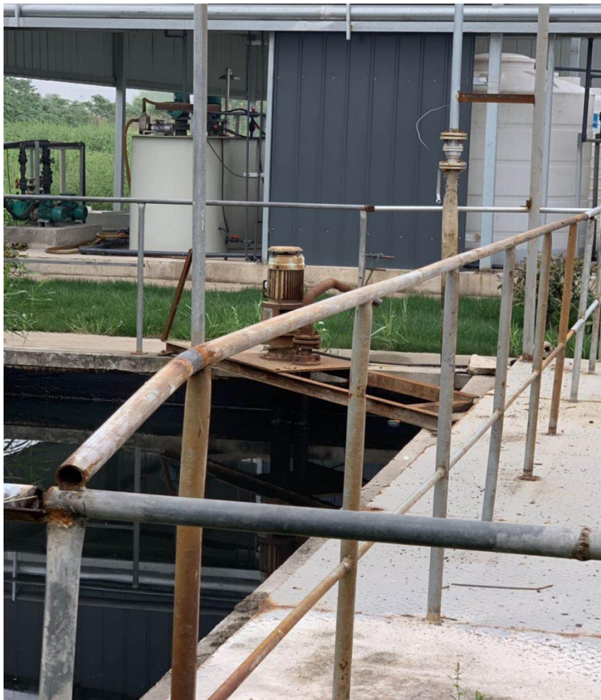
图 4.1-5 脱硫废水回用泵
