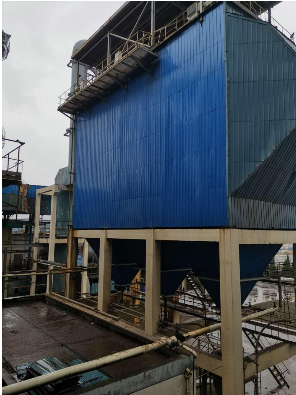
图 4.1-9 电袋除尘设施
