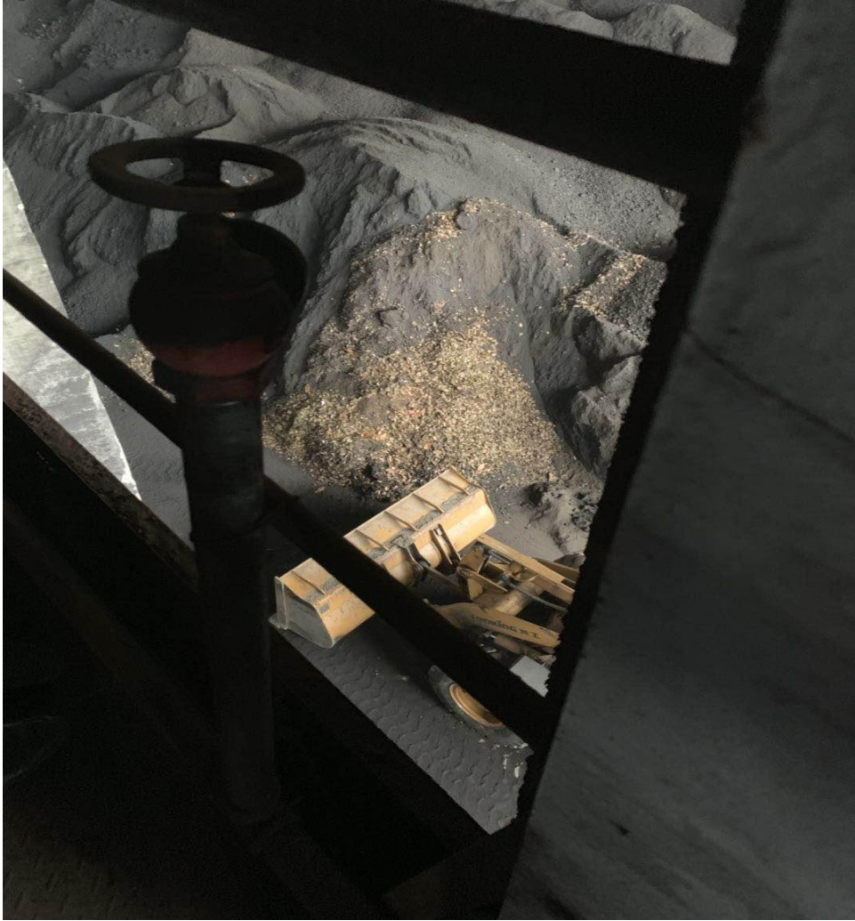
图 4.1-6 脱硫废水煤库喷淋装置
