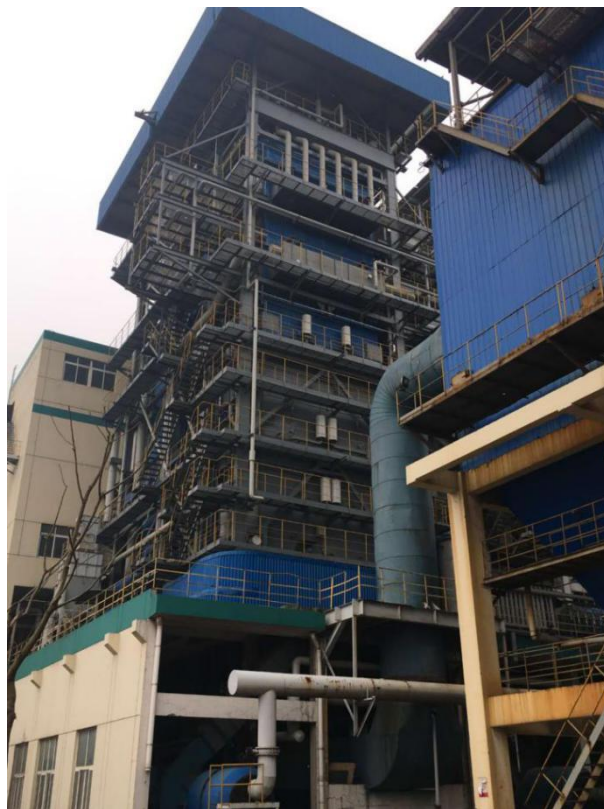
图 4.1-7 SNCR-SCR 组合脱硝设施
