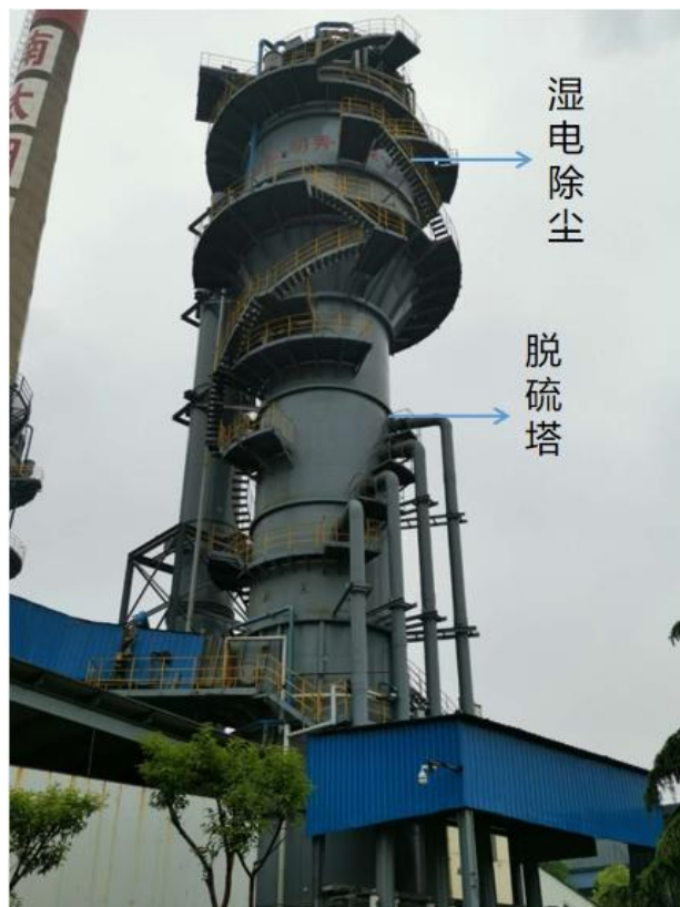
图 4.1-8 脱硫塔及湿电除尘装置
