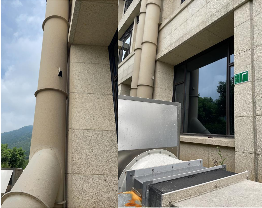
图 4.1-2 本项目排气筒及废气处理设施
