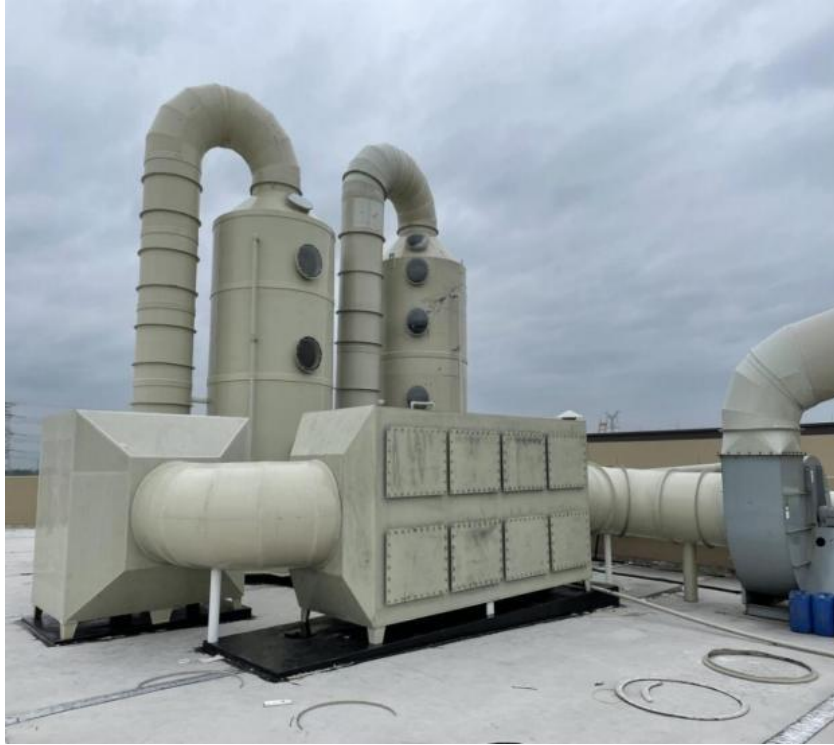
二级碱液喷淋塔+除湿+活性炭吸附塔
