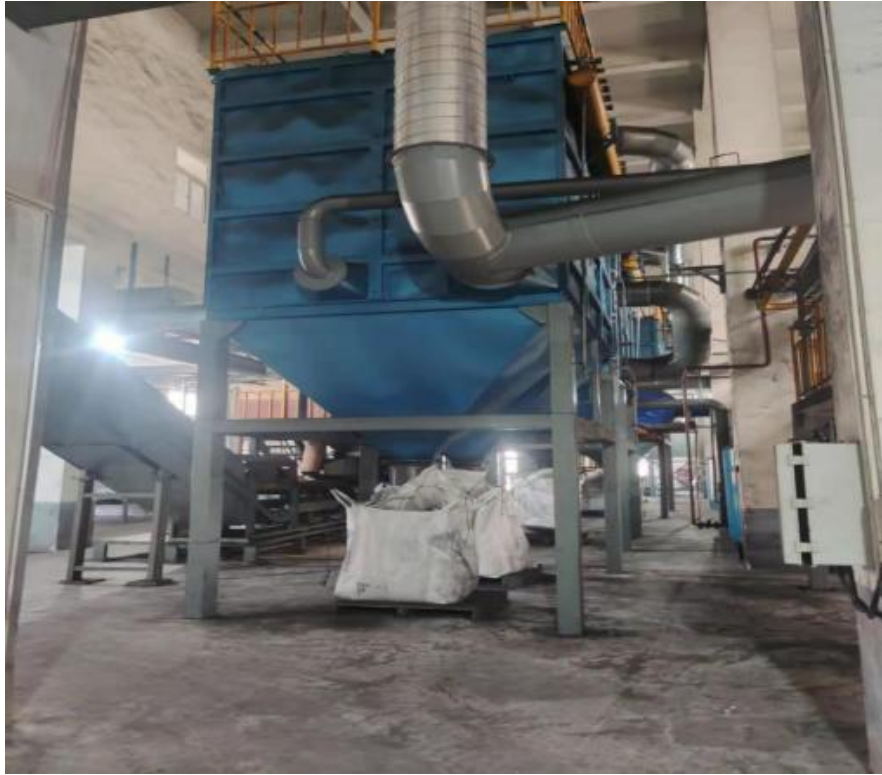
粗破、分选工序、钢带炉还原布袋除尘装置
