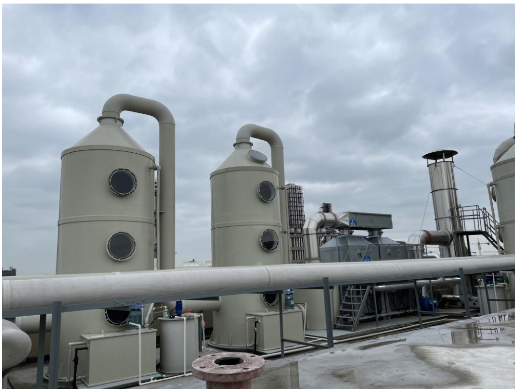
二级喷淋吸收塔（碱液喷淋）+除湿+活性炭吸附脱附—催化燃烧
