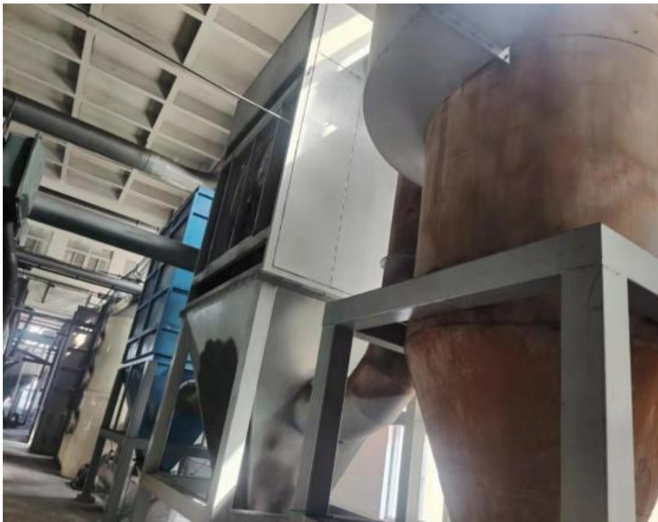
焙烧工序冷却器进行急速降温+布袋除尘装置
