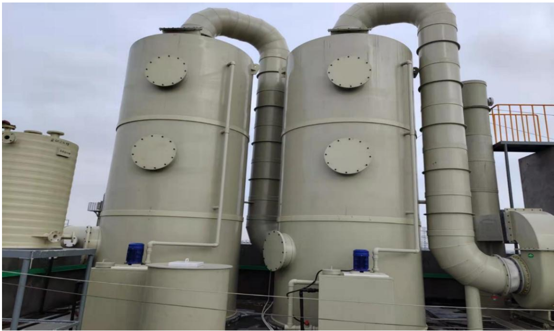
污水站碱喷淋装置
