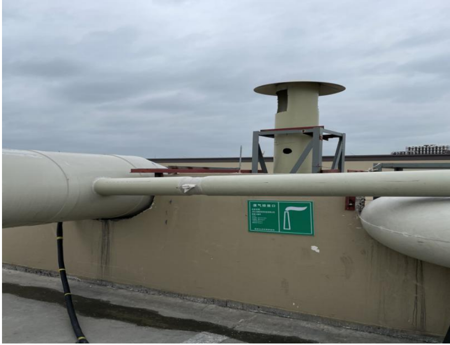
燃气废气排气筒
