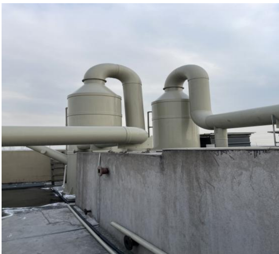
二级喷淋吸收塔（共 5 个喷淋塔，酸雾均通过其中两个喷淋塔处理后排放）
