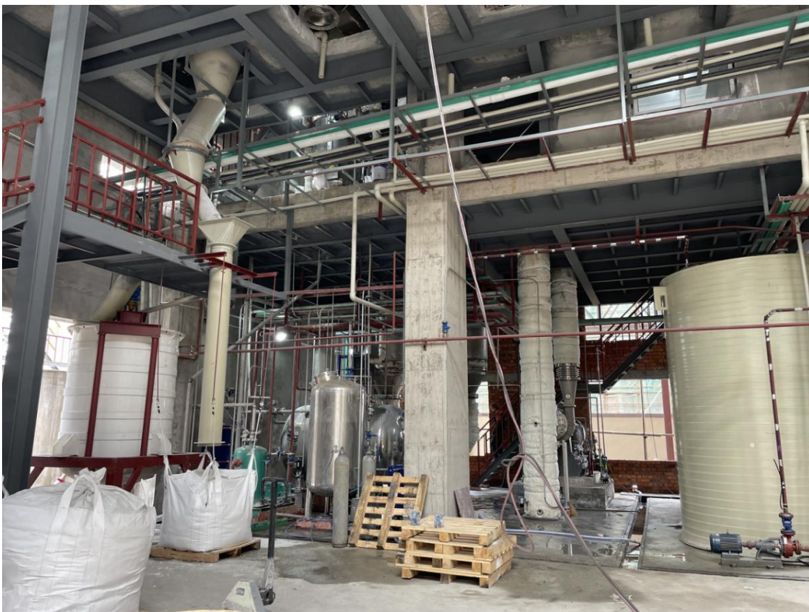
含盐废水 MVR 预处理
