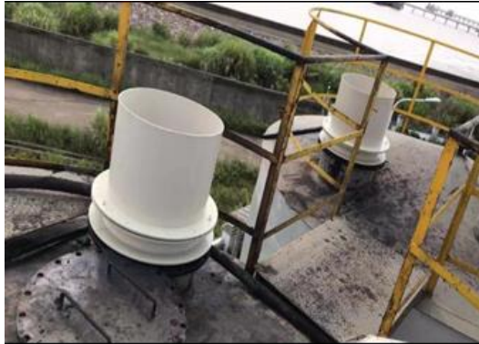
图 4.1-15 废油水混合物储罐活性炭吸附装置
