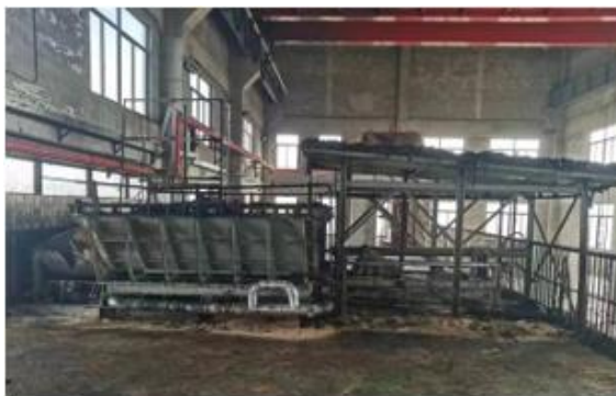
图 3.5-5 焚烧线下料斗
