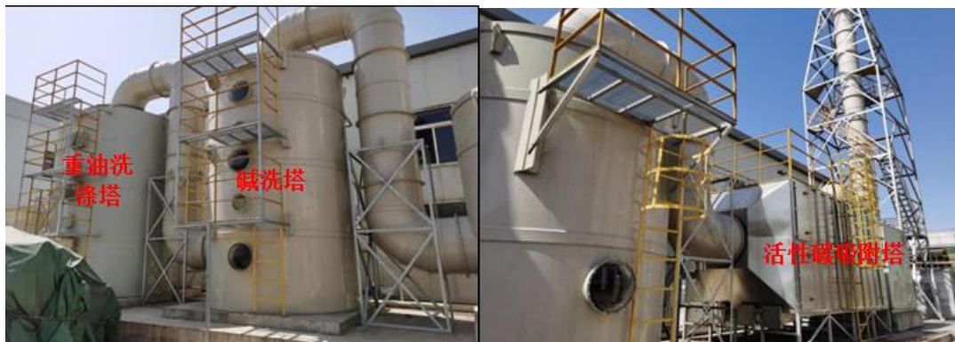
图 4.1-12 油泥车间废气处理设施
