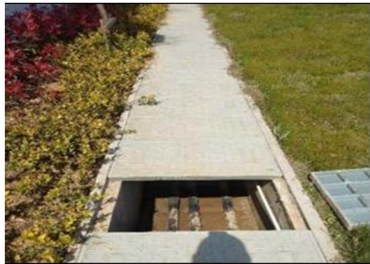
图 4.1-4 厂区废水管、沟
