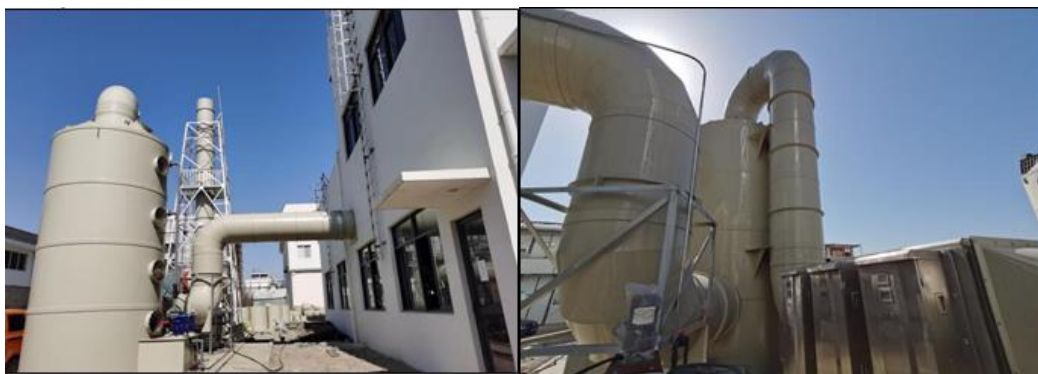
图 4.1-14 资源化车间废气处理设施
