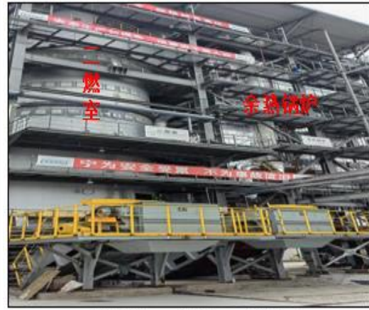
图 3.5-4 二燃室和余热锅炉
