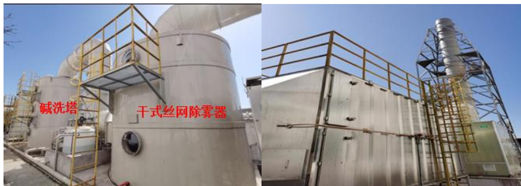
图 4.1-13 油泥暂存库废气处理设施
