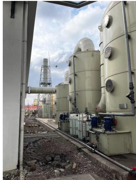
图 4.1-16 丙类仓库 2#预处理车间废气处理设施
