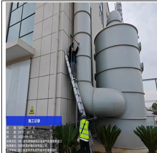
9#: 废包装桶破碎设备废气处理装置进口
