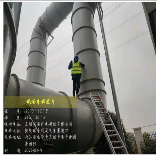
16#: 预处理车间废气装置进口
