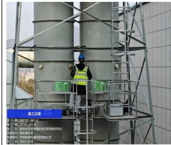
17#: 预处理车间废气装置出口
