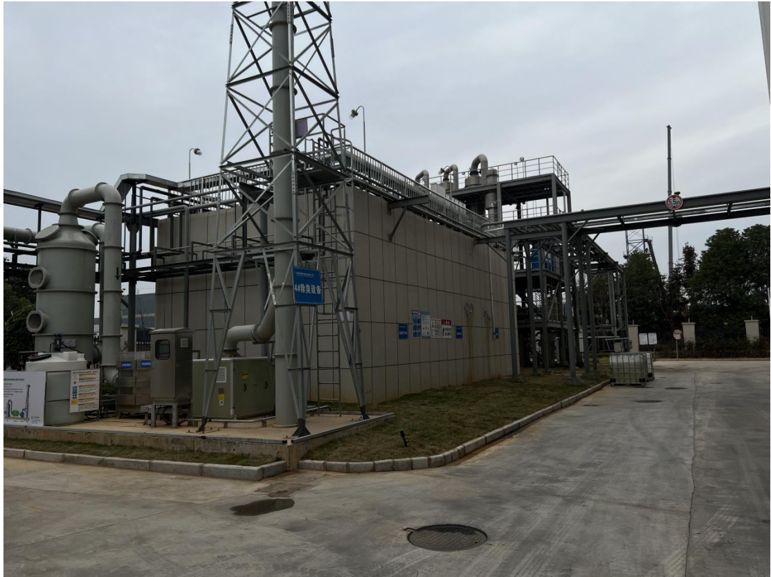
图 4.1-15 污水处理站废气处理设施
