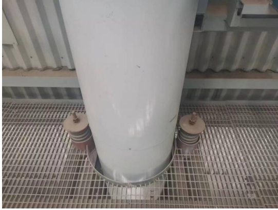
图 4.1-16 余热锅炉减震装置
