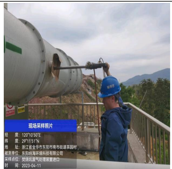
12#: 焚烧坑废气处理装置进口
