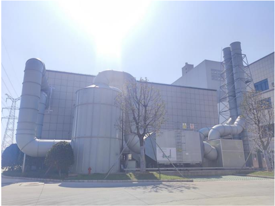
图 4.1-13 预处理车间废气处理设施及暂存库车间废气处理设施
