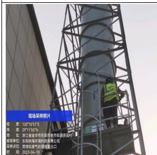
13#: 焚烧坑废气处理装置出口
