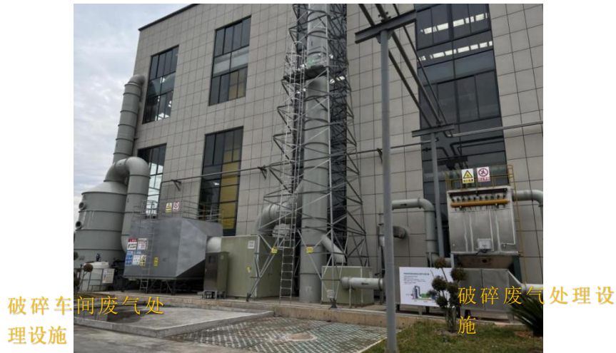
图 4.1-12 破碎废气处理设施
