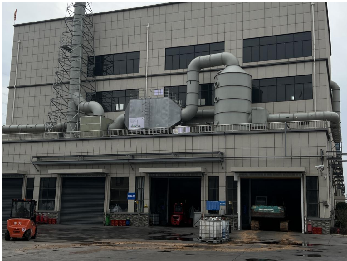
图 4.1-14 焚烧车间（料坑）废气处理设施
