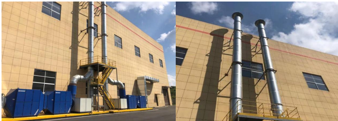
图 4.1-2 4#非挥发性固体废物车间废气处理设施
