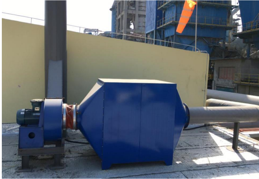
图 4.1-1 2#固态车间废气处理装置
