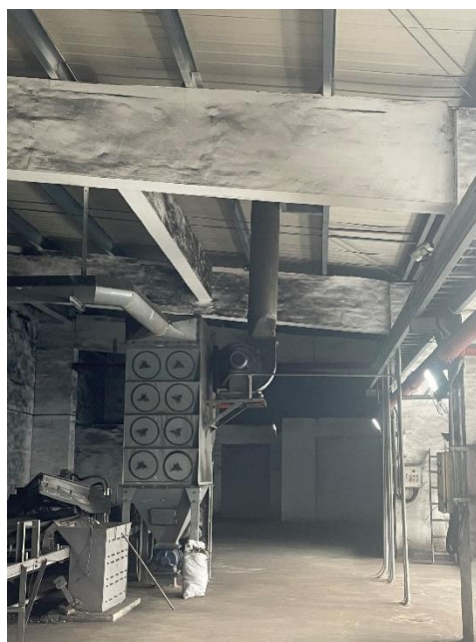
图 3.1-4 1#炉前料仓布袋除尘装置
