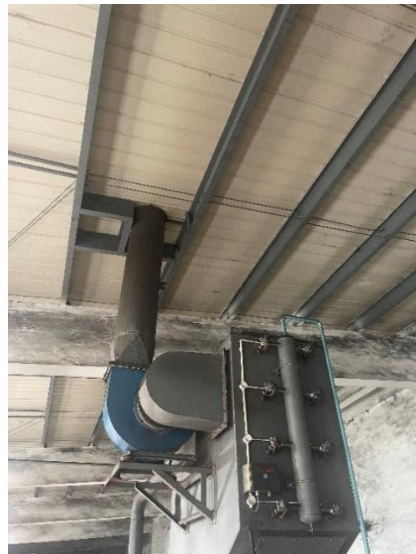
图 3.1-6 3#炉前料仓布袋除尘装置
