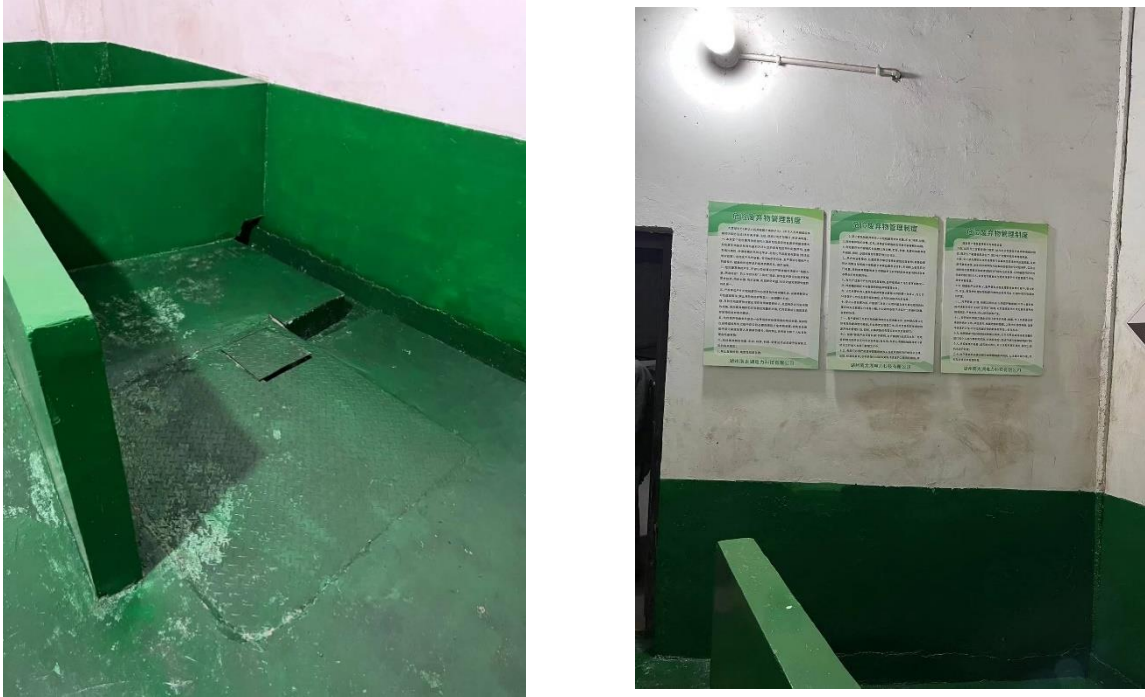
图 3.4-1 危废仓库现状
